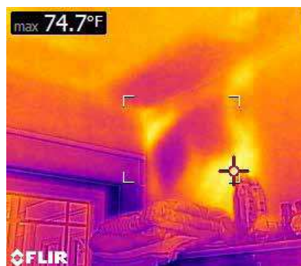
Fehlende Dämmung an einem Sommertag E6 mit MSX
